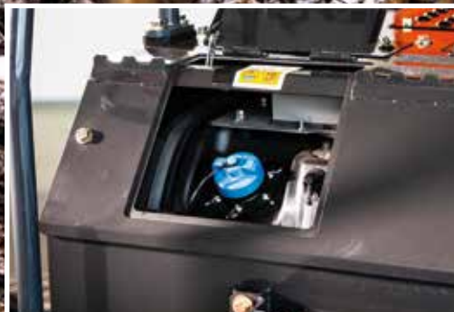
Adblue® sprøytes inn i eksosgassen for å redusere utslipp.
