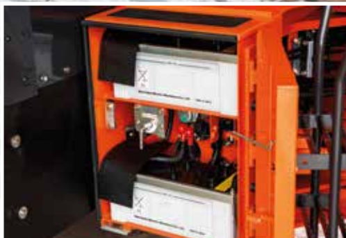
Batteriet er lett å vedlikeholde.
